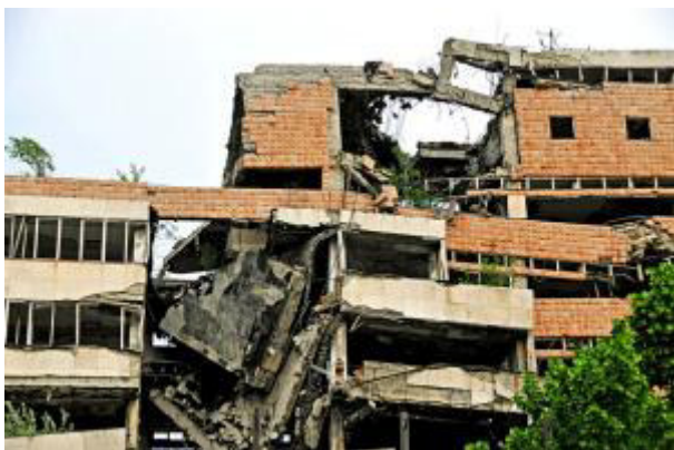
Bei NATO-Einsatz zerstörte Häuser in Serbien Foto von Dennis Jarvis
